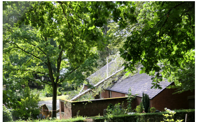
Umgestürzte Birke auf dem Dach der Friedhofshalle
